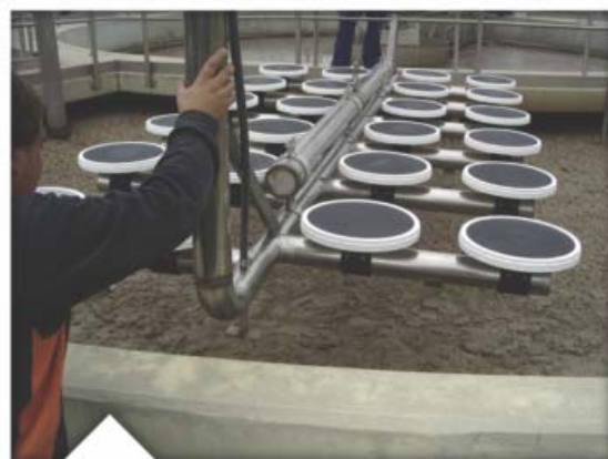
Les diffuseurs à disque fournissent une efficacité élevée et exceptionnelle du transfert d'oxygène dans cette cuve d'aération en Espagne.
