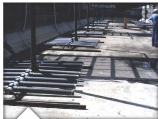
Ces grilles amovibles fonctionnent depuis plus de 10 ans dans cette station d'épuration municipale des eaux usées.
